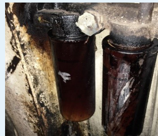
Se calentó tanto el fluido del depósito que se fundió y levantó la pintura del fondo del depósito
